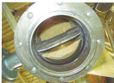
排出口を下から覗いたところ 完全なブリッチを形成している。
